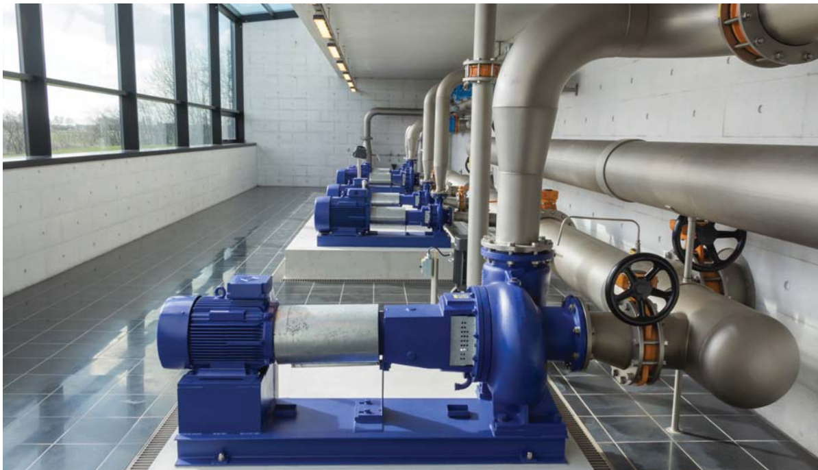
Elektrisch betriebene Pumpen in geerdeten Netzen, die überwiegend abgeschaltet sind, können mit Differenzstromwächtern nicht permanent überwacht werden.
